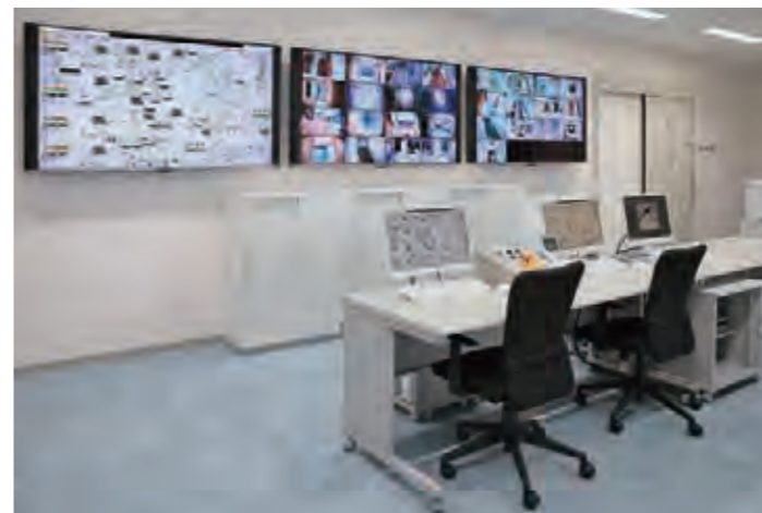
施設内の各機器の稼働状態を集中監視し、コントロールします。
