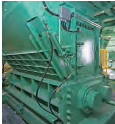
低速回転破砕機 不燃ごみ・粗大ごみの処理がしやすいように粗く破砕します。
