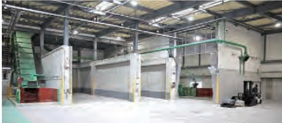
プラットホーム 収集された不燃ごみ・粗大ごみを受入、一時貯留するエリア。
