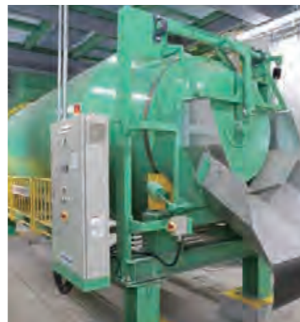
粗大破砕物貯留ドラム 破砕されたごみから出た可燃残渣、手選別コンベヤで選別された可燃物を貯留します。
